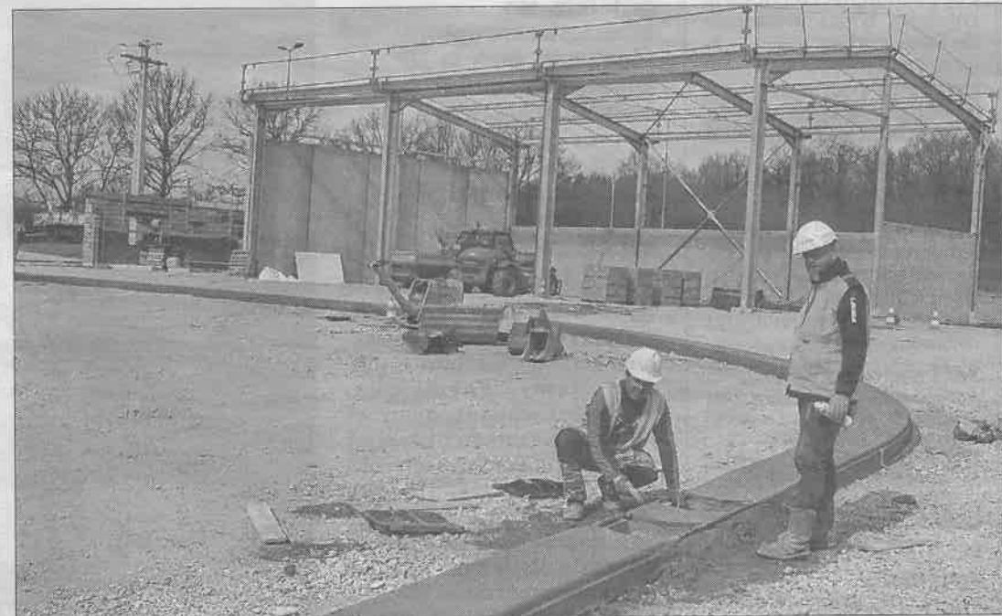
Après d'importants travaux de terrassement, la déchetterie prend peu à peu forme. Un bâtiment couvert permettra notamment de protéger les déchets sensibles à la pluie.
